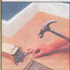
Старый дощатый пол покрывают ДСП, сразу «устраняющей» все его дефекты. Основание получается ровным и чистым.
